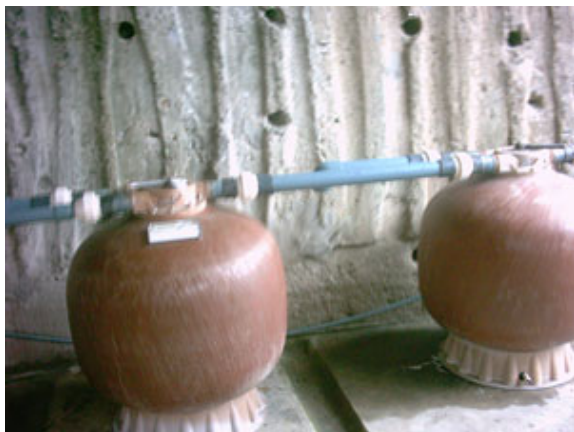
Die Filter der Wasseraufbereitungsanlage
