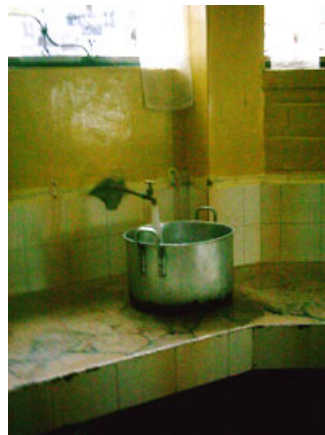
Trinkwasser in der Küche...
